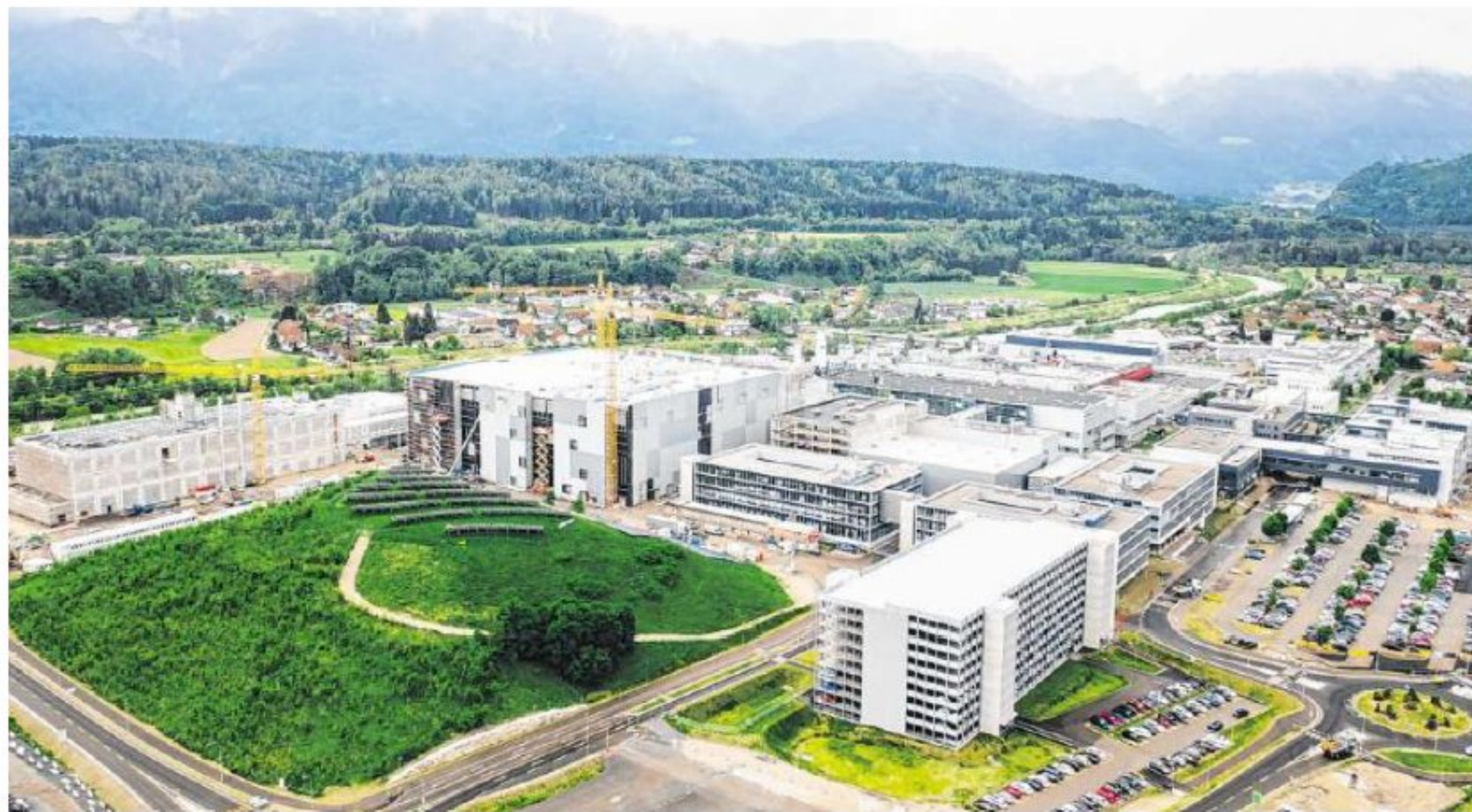
In Villach (Kärnten) entsteht für 1,6 Milliarden eine Chip-Fabrik von Infineon. Für den Einbau der Reinraumböden zuständig ist das Sulzberger Unternehmen Epoflor mit einem Auftragsvolumen von 3,5 Millionen Euro. Foto: Infineon
