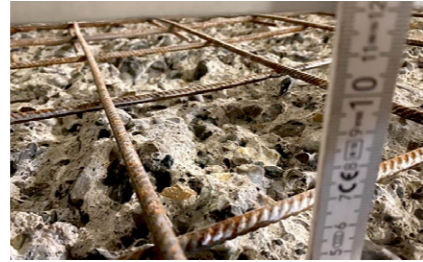
Freigelegte korrodierte Bewehrung
