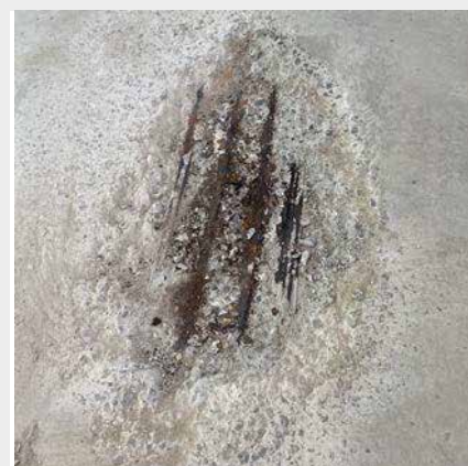
Freigelegte korrodierte Bauteile
